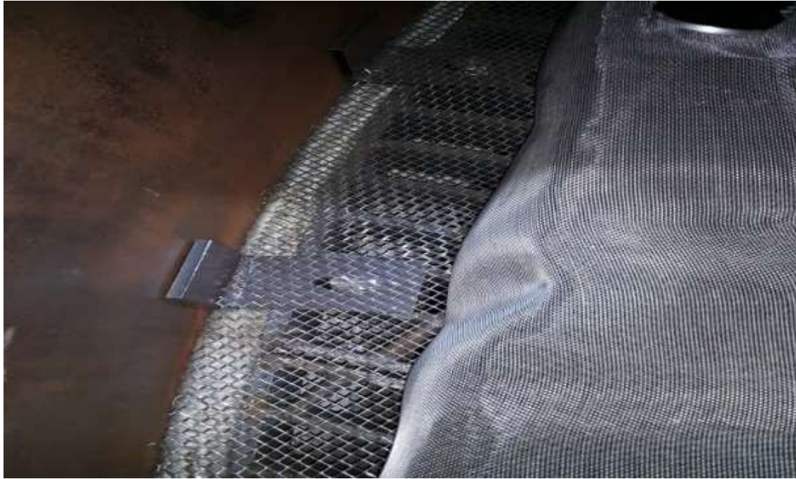
شکل (۱۱) عدم اتصال مش ها به دیواره درایرها
