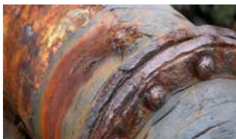
شکل (۱): نمونه ای از لوله های خورده شده
