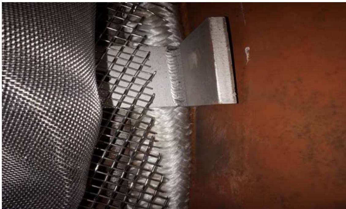
شکل (۱۰) عدم اتصال مش ها به دیواره درایرها
